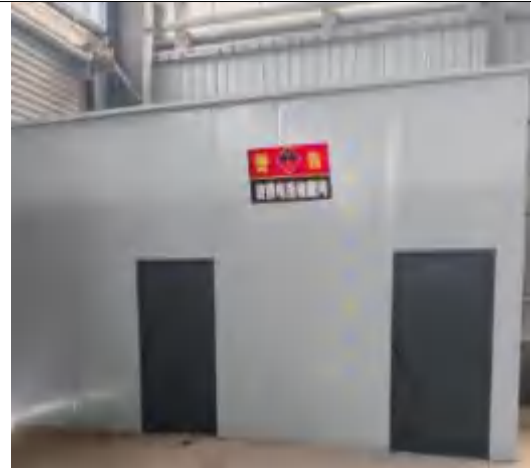
密闭的破损电池贮存间
